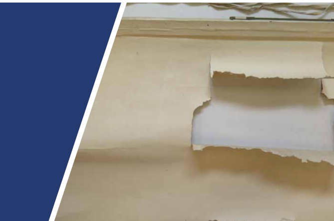
▲ 纸料裱边出现严重破损，天杆边出现开裂情况
